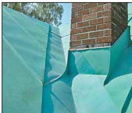
Воротник каминной трубы, частично перекрывающей ендову.
