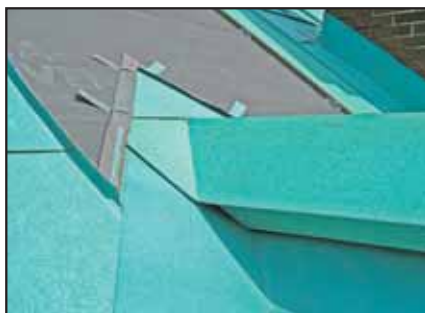
Узел врезки объёмного вентилируемого конька в основную кровлю выполнен по технологии, разработанной специалистами компании «Саврос».
