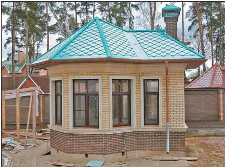
Беседка. Кровля выполнена объёмными ромбами из патинированной меди КМЕ. На таких объектах реально закрепляются навыки, полученные при обучении на макетах.
