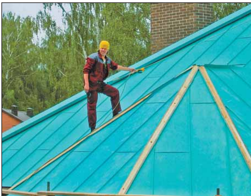
Один из моих первых учеников — сын Ярослав. Монтаж объёмных коньков кровли эркера. Материал — патинированная медь КМЕ.
